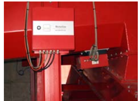
Einbau an der Austragschnecke des Spänesilos
